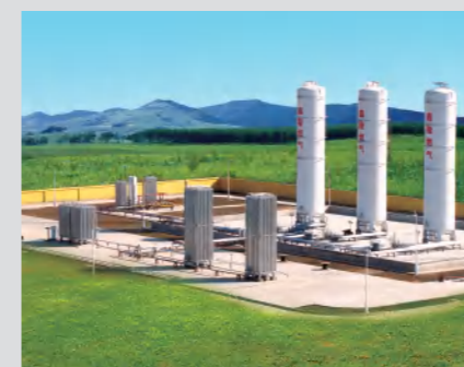
青海隆鑫燃气LNG、L-CNG项目EPC总包 Qinghai the Loncin Gas LNG, L-CNG Project
