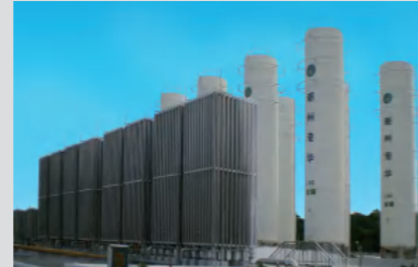
潮州港华空温式LNG气化器现场 Jobsite of Chaozhou Towngas LNG Ambient Vaporizer
