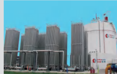
中燃芜湖空温式LNG气化器现场 Jobsite of China Gas (Wuhu) LNG Ambient Vaporizer
