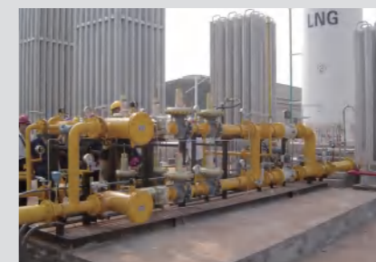
LNG气化站减压计量撬 LNG Gasification & Pressure Regulating & Metering Skid
