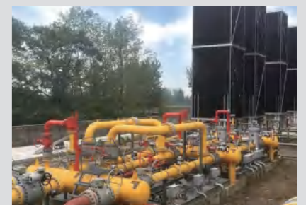
LNG调峰站调压撬 LNG peak shaving station pressure regulating skid
