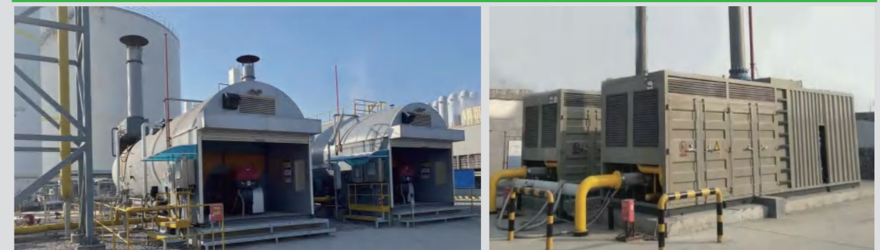
空分后备供气现场 Air separation backup gas supply site
