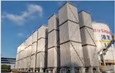
Air Liquide 无锡华虹电子气项目 18x7500NM 3 /h气化器现场 Electronics Gas Project for AL Wuxi HuaHong, 18x7500NM 3 /h ambient vaporizers
