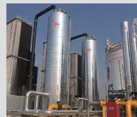
合肥燃气60000Nm 3 /h LNG 气化器&U型管板NG加热器 60,000Nm 3 /h LNG Water-bath Vaporizer and U-tube plate Heater for Hefei Gas Group
