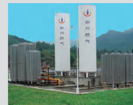
务川新兴燃气LNG、L-CNG项目EPC总包 Wuchuan Emerging Gas LNG, L-CNG Project
