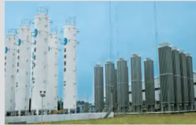
徐州港华16000Nm 3 /h分段式气化器 Jobsite of Xuzhou Town Gas16,000Nm 3 /h Splitted Vaporizer
