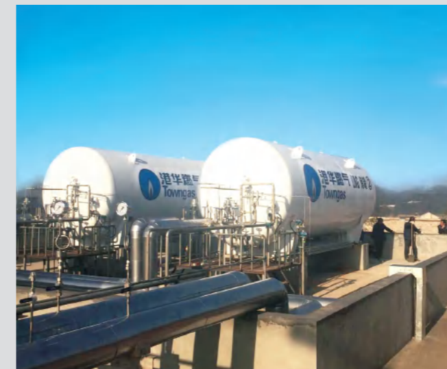
港华燃气LNG气化站项目EPC总包 LNG gasification EPC project for Towngas Co.
