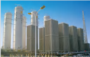
大连华润燃气公司空温式LNG气化器现场 Jobsite of Dalian China Resources Gas LNG Ambient Vaporizer
