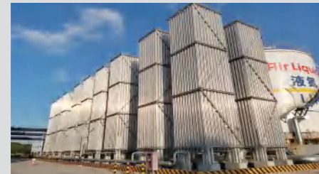
液化空气无锡华虹电子气项目 18X7500Nm 3 /h 气化器现场 Electronics Gas Project for AL Wuxi HuaHong, 18X7500Nm 3 /h ambient vaporizers
