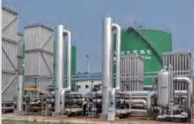
河北天然气立式U型管LNG气化器现场 Jobsite of vertical U tube plate LNG vaporizer for Hebei Natural Gas Company
