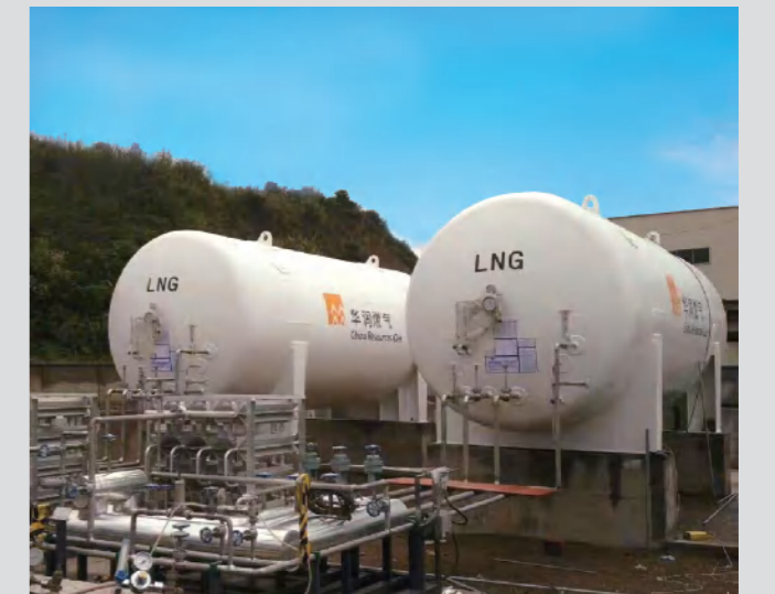
华润燃气LNG气化站项目EPC总包 LNG gasification EPC project for China Resources Gas Co.
