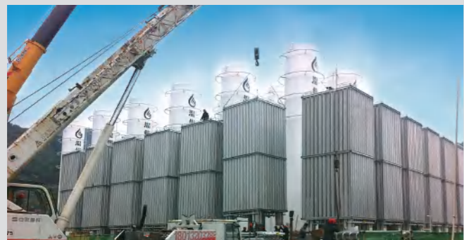
温州燃气LNG调峰站 Wenzhou Gas LNG Peak Shaving Station
